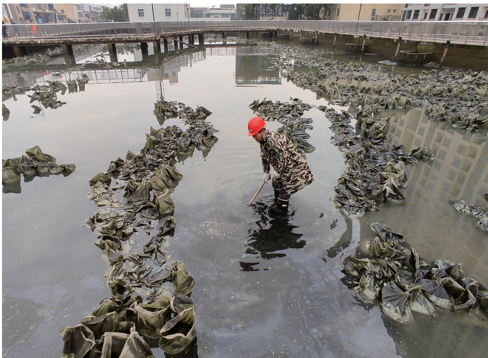
为保障建设桥机埠排渍功能正常运行,施工人员赶在雨季来临前对机埠过滤池进行清淤。图为昨日施工现场。徐珊珊 摄
